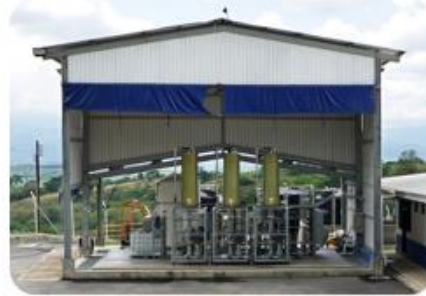
TRATAMIENTO DE LIXIVIADOS
