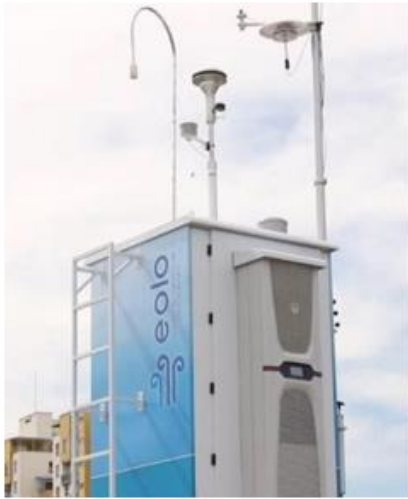
ESTACION DE MONITOREO DE LA CALIDAD DEL AIRE
