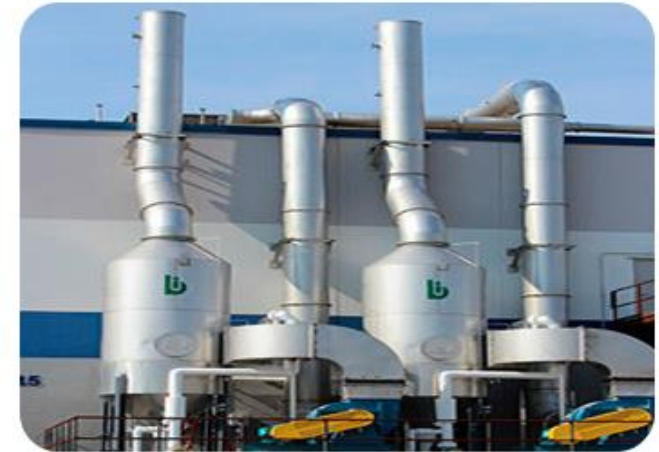
LAVADORES DE GASES
