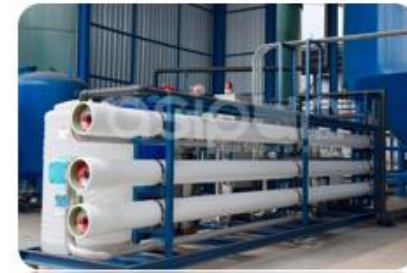
EQUIPOS DE OSMOSIS INVERSA
